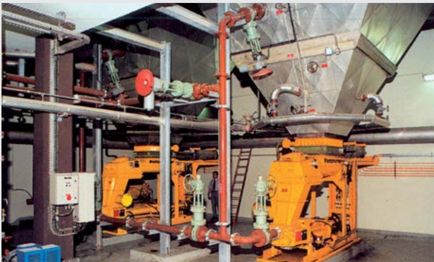
Pompes KOS 1030 d'introduction des graisses dans le four de désodorisation
