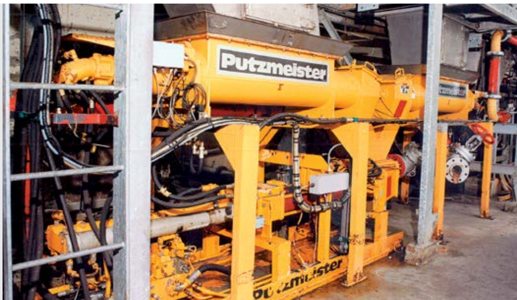
La pompe KOS 1030 est alimentée alternativement par 2 gaveurs recevant les boues provenant des deux dégraisseurs
